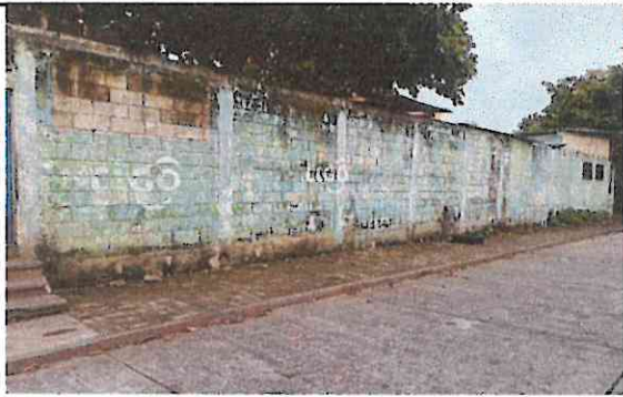
Foto 1: El muro perimetral se encuentra deteriorado, parte exterior
