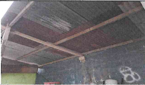
Foto 3: El techo se encuentra en mal estado
