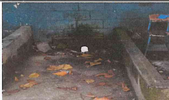
Foto 8: No es suficiente la salida de agua
