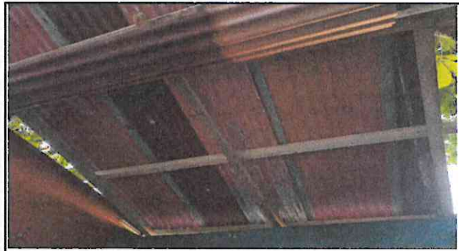
Foto 4: El techo se encuentra en malas condiciones.
